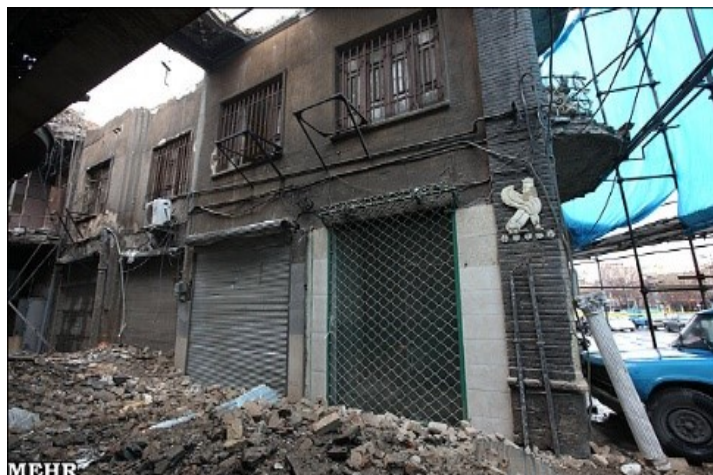
تصویر شماره ۱۵: تخریب ساختمان پرچم، برگرفته از (کریمی، ۱۳۸۹، ص: ۱۰۰)
